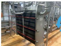
Теплообменник Alfa Laval заказчика
